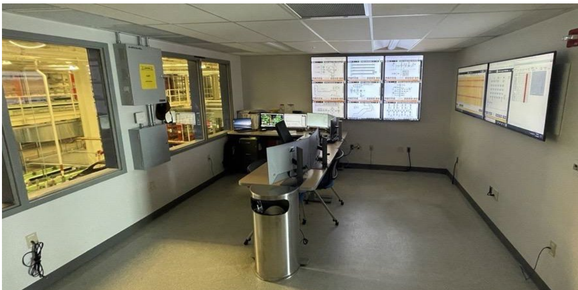
Figur 30. Kontrollrum i VCCH
