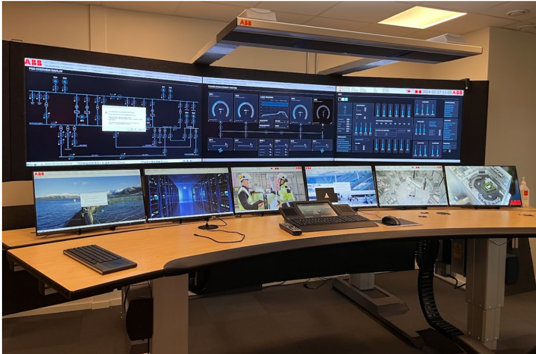
Figur 42. Kontrollrum "Extended Operator Workplace" från ABB
